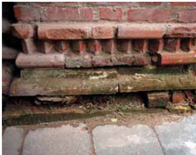
27. Новая трапезная. Разрушающийся цоколь, восстановленный в 1980-х годах. Июнь 2008 г.
