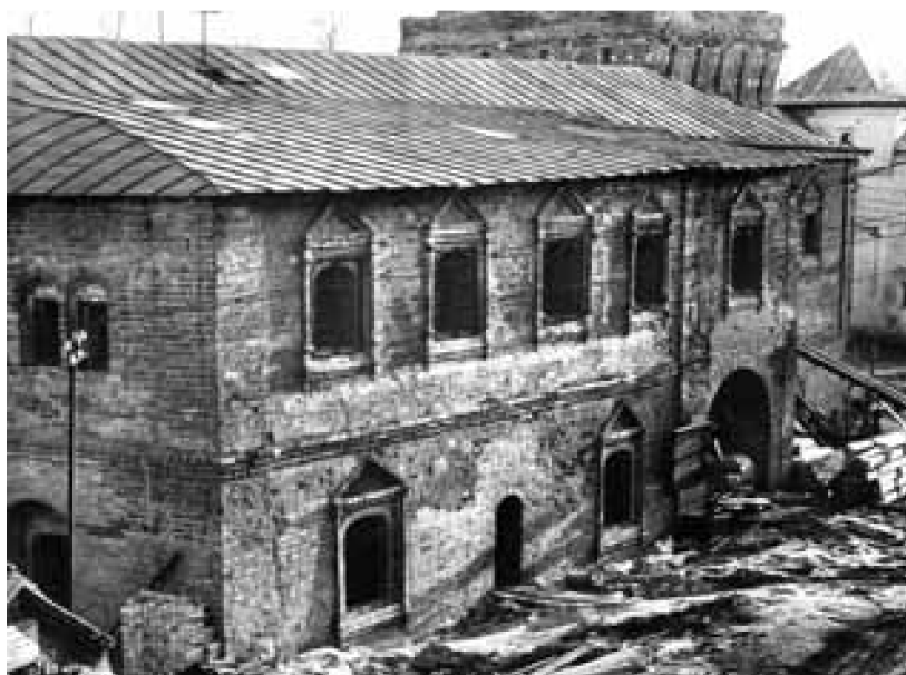
Старая трапезная (Келарский корпус). Вид с северо-запада в процессе реставрации. 1960-е гг. .
