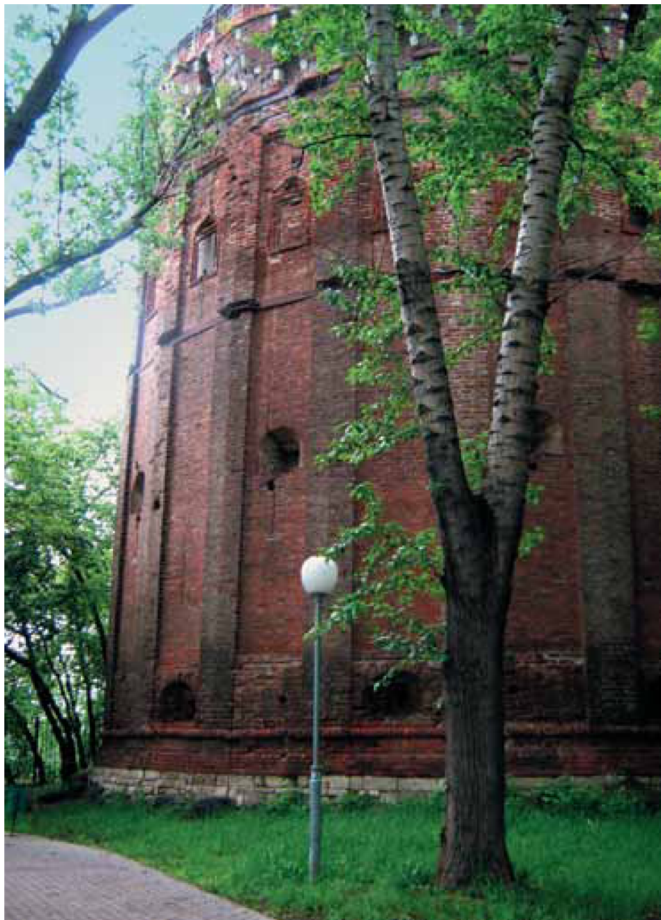
5. Башня Дуло. Вид с юго-востока. Состояние нижней части башни. Май 2016 г.
